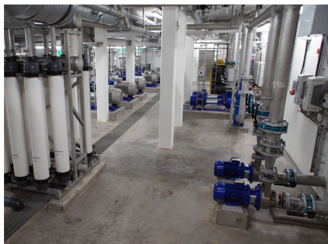
Bild 5. Pumpsal med UF-steg 2
